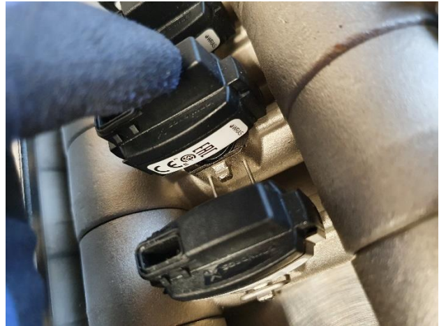
8. Quando o sensor é colocado na vertical, ele pode ser empurrado para baixo na tubulação
